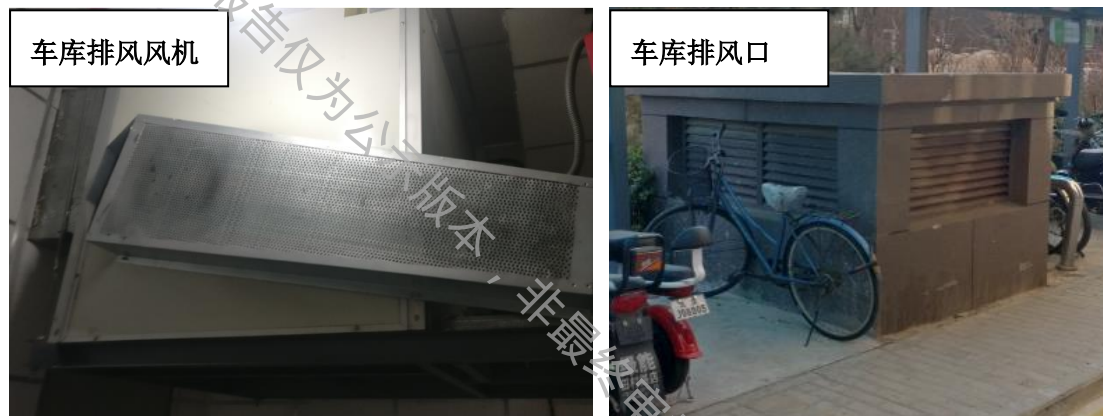
图 4-1 车库排气设施
