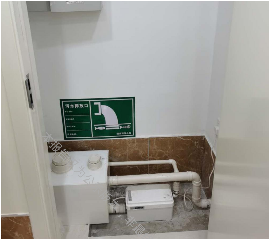
图 4-2 项目污水处理设备图
