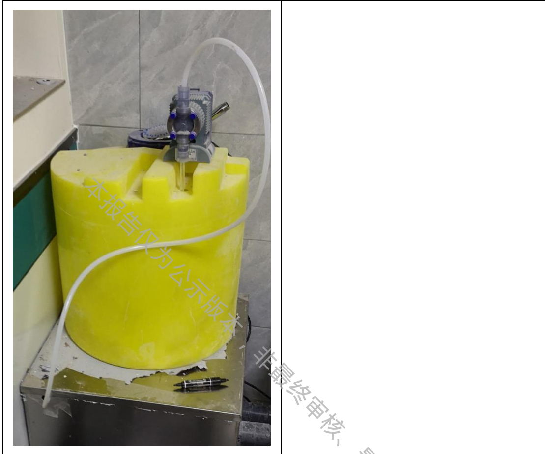
图 4-2 项目污水处理设备图
