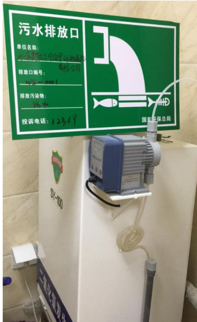
图 4-2 项目污水处理设备图
